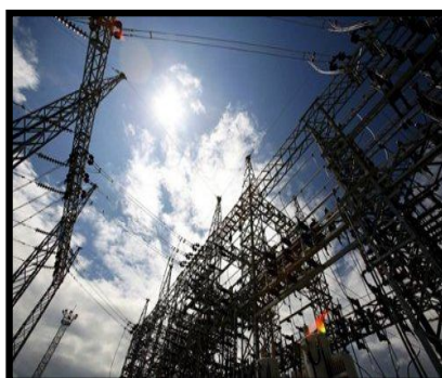
Awaria systemów elektroenergetycznych
